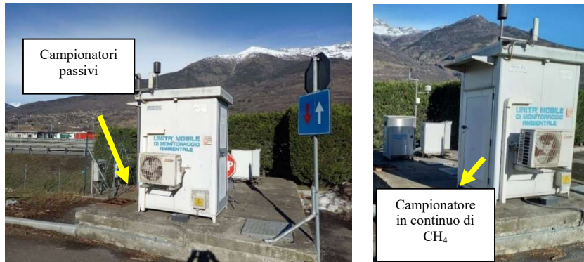
Piazzola monitoraggio qualità dell'aria discarica di Brissogne.
